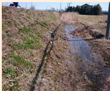
漏水発生状況
