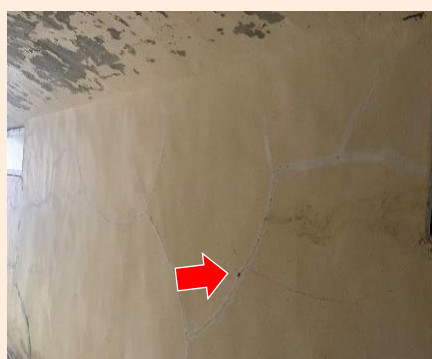
壁面にひび割れが発生
