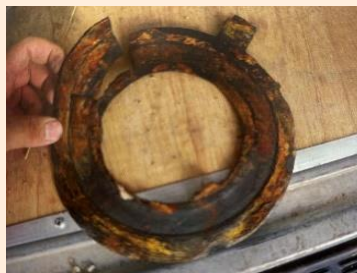
老朽化による水道管接続部の腐食状況
