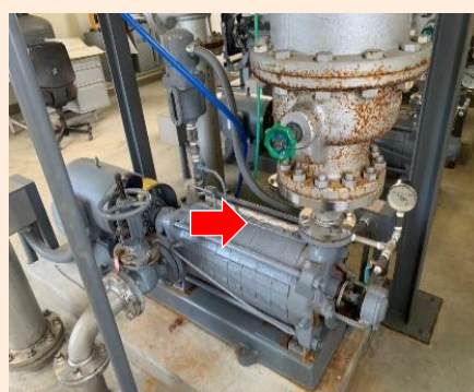
腐食が発生している配管
