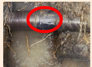
老朽化による水道管の腐食状況
