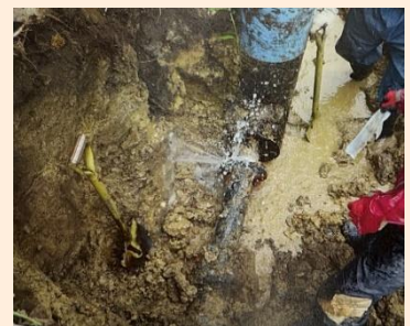
水道管(配水管)から漏水している状況
